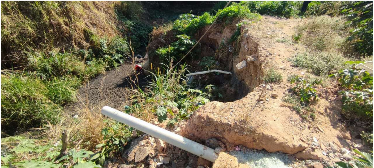
Foto 3 – Processo erosivo às margens do córrego Bela Vista.
