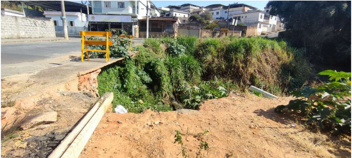
Foto 1 – Vista do processo erosivo a confluência das ruas Joaquim Ferreira de Rezende e Flauzino Vaz da Silva.
