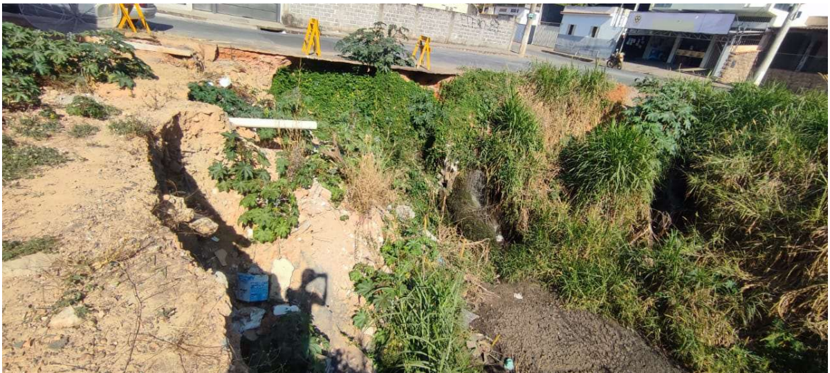
Foto 2 – Vista da erosão nas margens do córrego Bela Vista.
