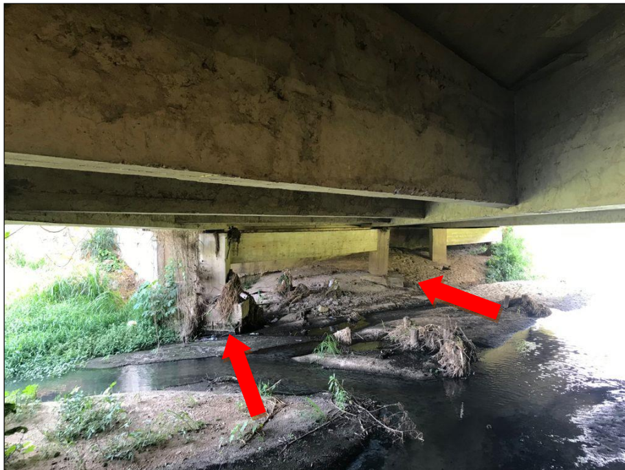
Figura 11. Bloco a proteger – ferragem exposta
